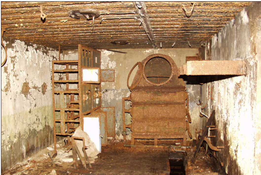
Rannapatarei nr 26 majutuspunkri kilbiruum. Tagaseinas vasakul elektrikilbi raam ja paremal ventilatsiooniseadme korpus. Laes näha elektrikaablite instalatsiooni rennid ja kinnitusklemmid, kaablid ise on kasutust leidnud mujal Hiiumaa elektrimajanduses.
