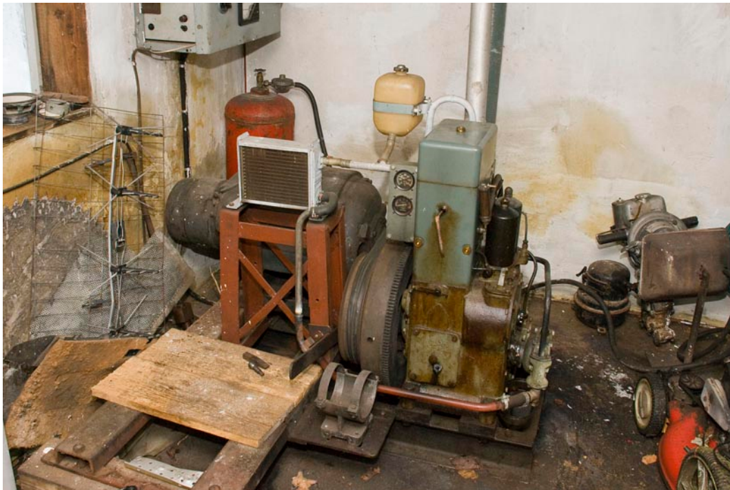
Kõpu Noorkõivu talu elektrigeneraator. Foto Mart Mõniste 2011.
